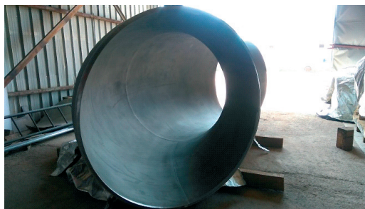
Rys. 3. Widok złącza doczołowego rur od strony grani; brak śladów utlenienia
